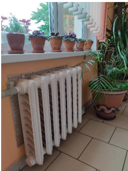
Фото 2. Батареи в коридоре
