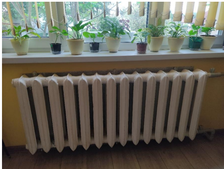
Фото 3. Батареи в учебном кабинете
